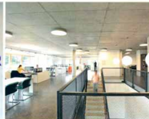
Im Verwaltungstrakt wirkt die Betondecke durch ein innenliegendes Rohrsystem als thermisches Bauteil.
